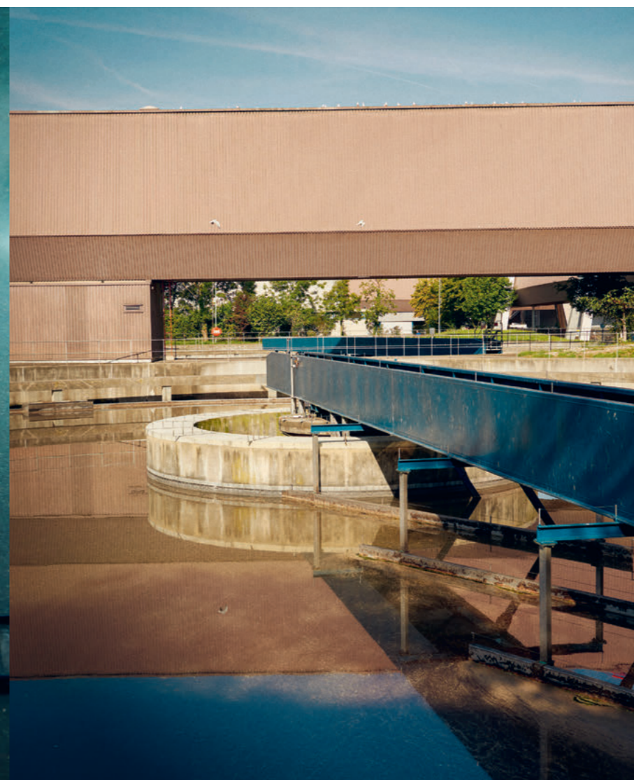
Wie der Zeiger einer riesigen Uhr: Bodenschieber im Vorklärbecken.
